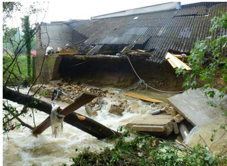
Dégâts causés par le ruissellement sur un bâtiment à Conliège lors des fortes précipitations de mai 2016
