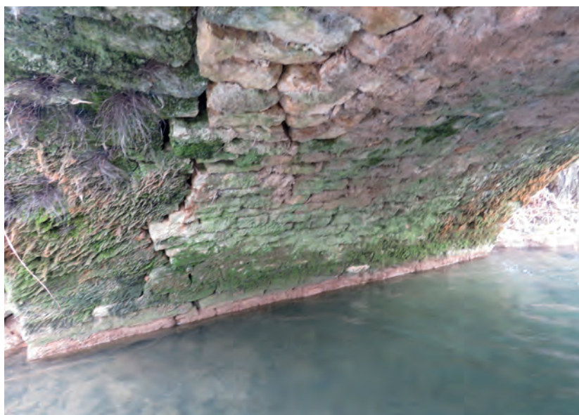
Les désordres structurels observés sur certains ouvrages nécessitent des travaux à très court terme
